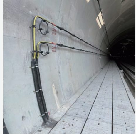
▲ 杭湖鐵路公網覆蓋項目
