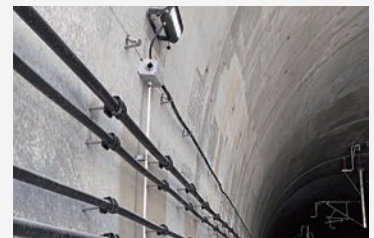
▲ 鄭萬高鐵隧道內基站、洩漏電纜共享建設
