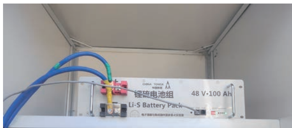
▲ 基站備電用鋰硫電池組
