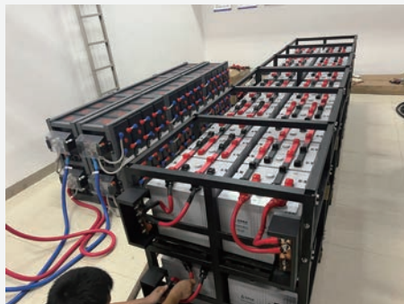
▲ 廣西電信通信機房動力配套電源設施備電現場
