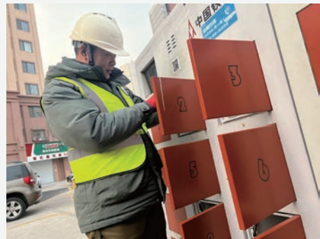
▲ 能源換電櫃隱患排查整治
