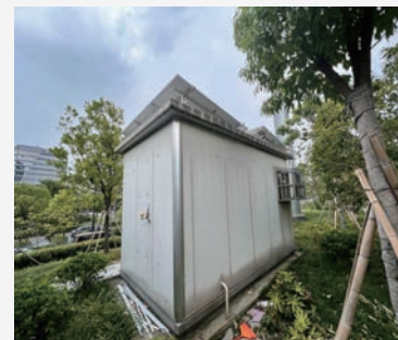
▲ 站內儲能設備和站頂光伏設備
